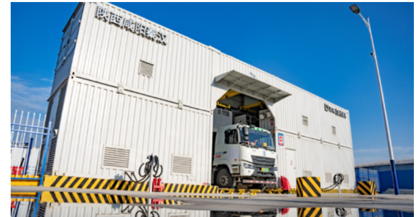
阳光铭岛绿色智能重卡充换电站
