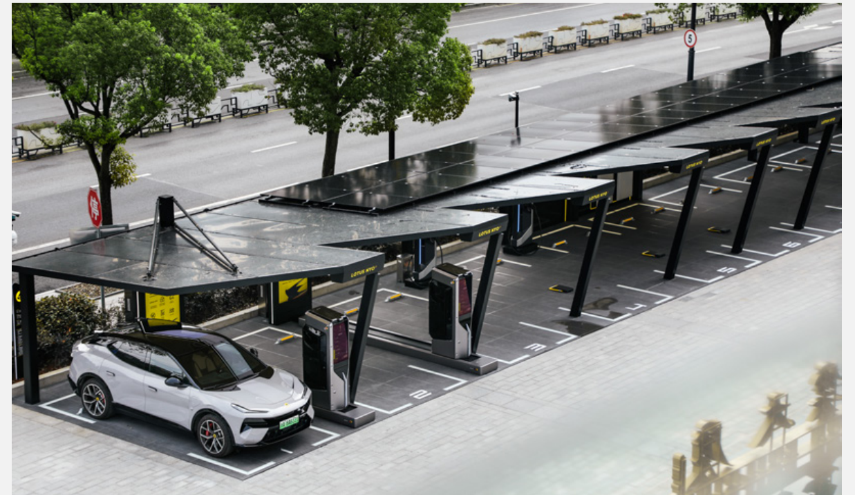
路特斯科技智慧光储充机器人超充站
